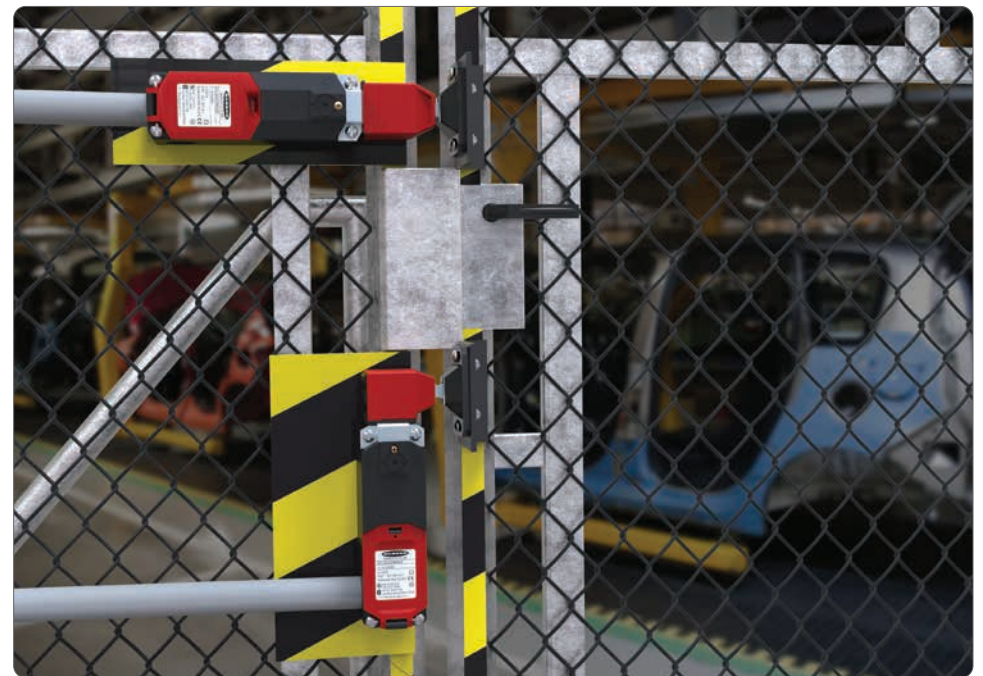
Interruptores de bloqueo en la puerta grande
