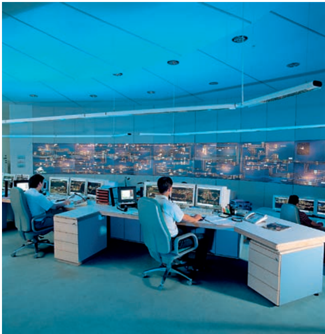
Centro de control ferroviario
